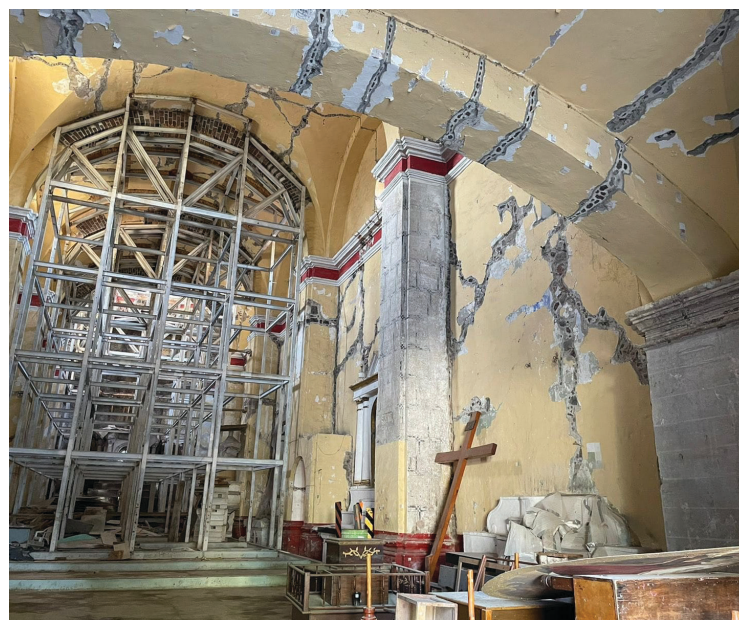
▲ El Templo de Santiago Apóstol en el municipio de Jiutepec resultó con severos daños en el sismo del 2017 y, aunque se ha reforzado, no puede ser reabierto al público. Foto: Redes sociales.
