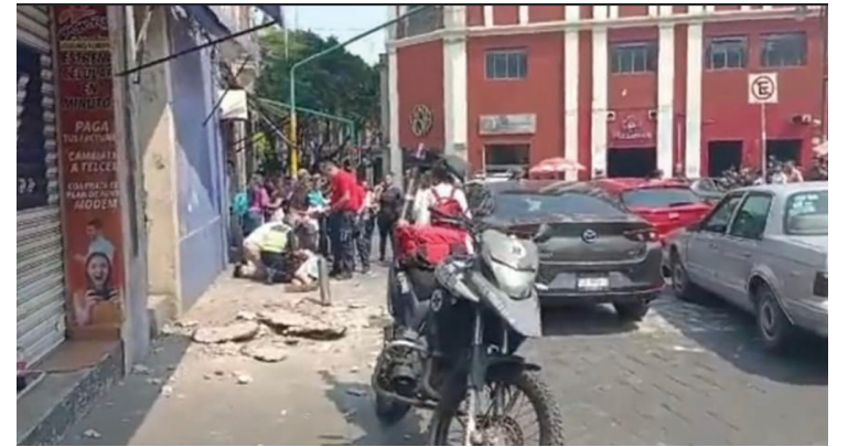
▲ La tarde del sábado 3 de junio una mujer resultó lesionada luego de que le cayeran restos de una fachada de un edificio, sobre la calle Matamoros, en el centro de Cuernavaca. Foto: Redes sociales.
