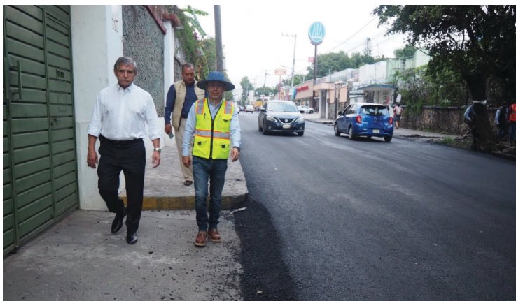
▲ El alcalde exigió a los encargados de la obra, trabajos de calidad. Foto: Ayuntamiento de Cuernavaca.
