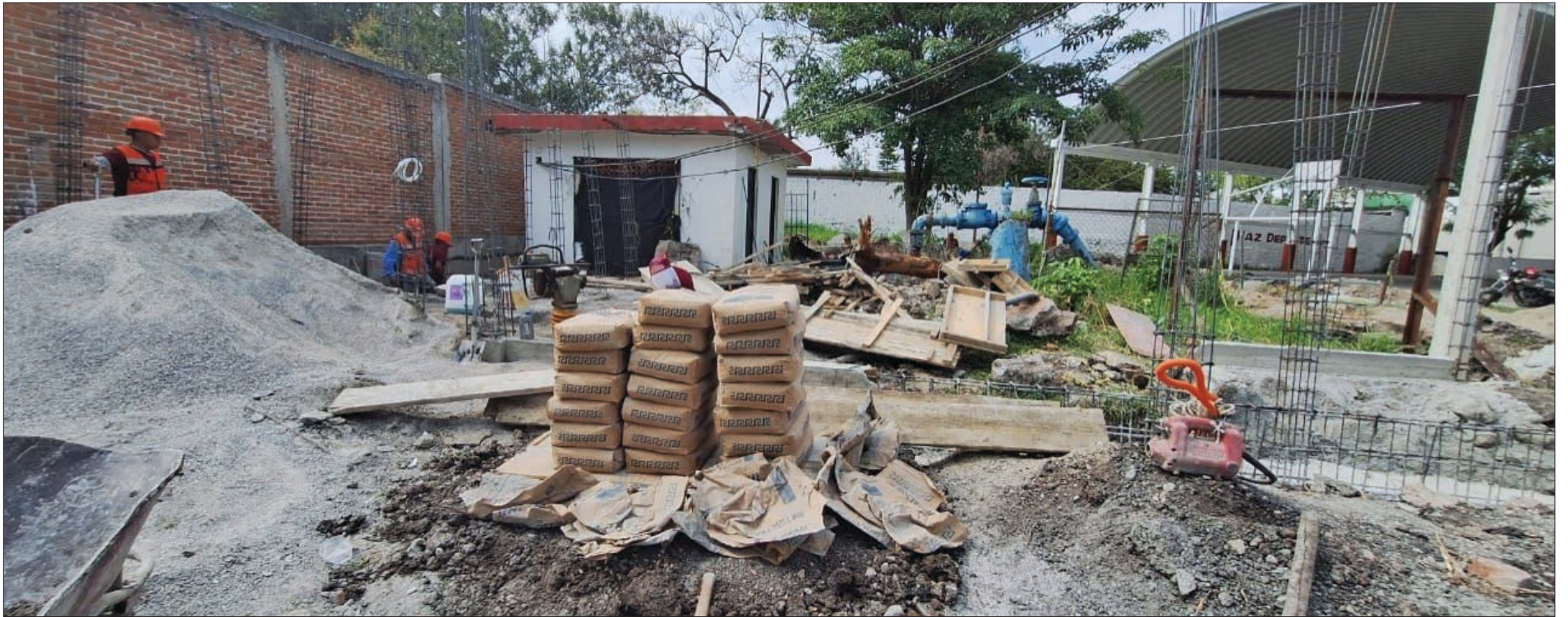
▲ El municipio invierte casi 5 millones y medio de pesos para el abastecimiento de agua potable y el desfogeo de aguas residuales para beneficio de su comunidad. Foto: Ayuntamiento de Jiutepec.
