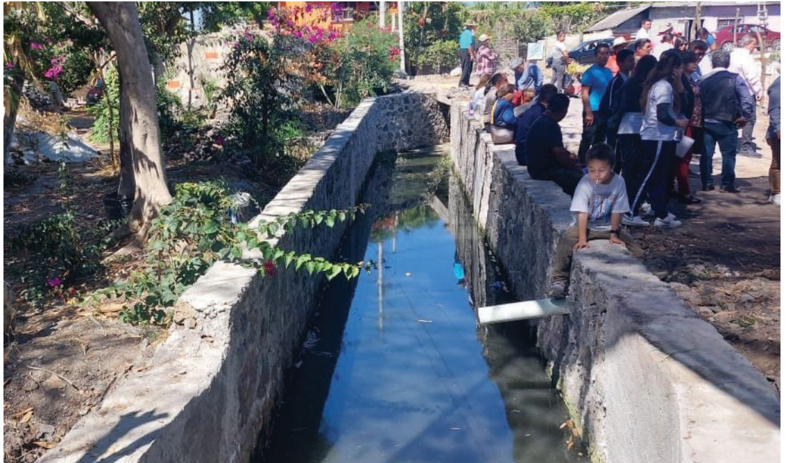
▲ El gobierno de Jiutepec invirtió un millón 800 mil pesos para la construcción de 337 metros cuadrados de revestimiento de canales de riego. Foto: Ayuntamiento de Jiutepec
