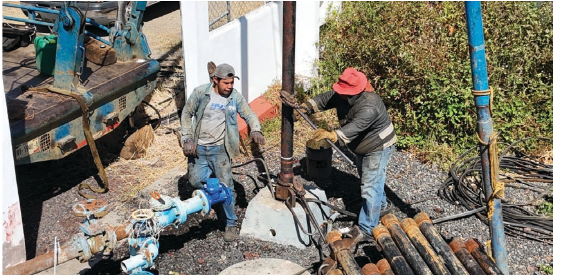
▲ Una de las acciones iniciales para garantizar el abasto de agua en el municipio fue profundizar 12 metros el equipo de bombeo en el pozo "Francisco Villa", beneficiando a 272 usuarios de varias colonias. Foto: Ayuntamiento de Jiutepec.
