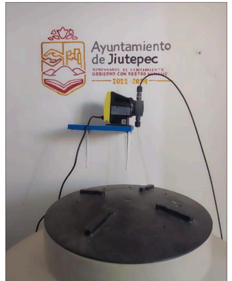
▲ Se instalaron 32 bombas dosificadoras de cloro en Jiutepec, en la imagen una de ellas. Foto: Ayuntamiento de Jiutepec
