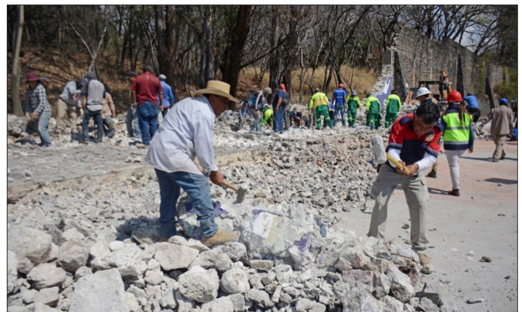
▲ El derrumbe de aproximadamente 30 metros lineales de barda perimetral, generó caos vial y una amplia movilización de personal para escombrar la zona. Foto: Ayuntamiento de Cuernavaca
