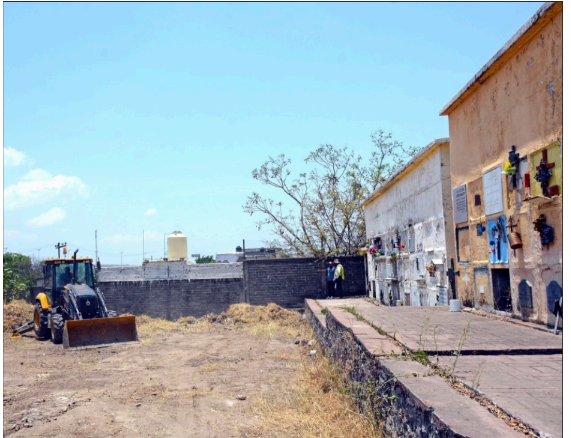
▲ Se informó que las acciones de mitigación de la zona de riesgo del panteón, particularmente en el área de 10 metros de ancho por cerca de 200 de largo en calle Bugambilias, buscan favorecer la estabilización parcial del talud del panteón. Foto: Ayuntamiento de Cuernavaca
