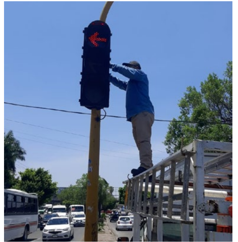
▲ Luego de años de abandono, los semáforos de los cruces de calles Guerrero y Degollado, en el Centro Histórico, así como de avenida Morelos Sur esquina con calle Cancún, en la colonia Quintana Roo, ya están funcionando correctamente. Foto: Ayuntamiento de Cuernavaca.
